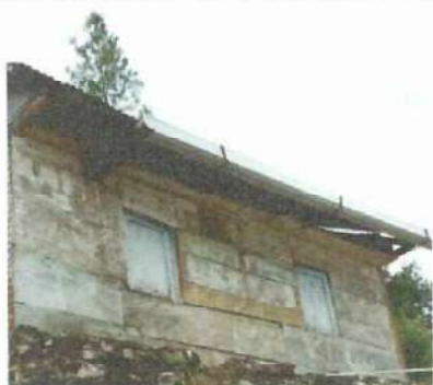
Foto 3: Vista de Cocina con deterioro en paredes y techo.
