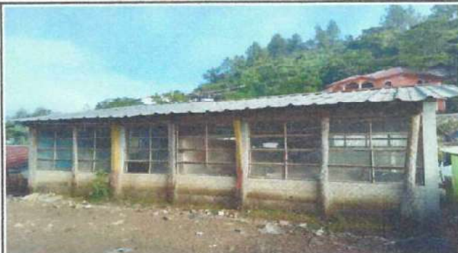
Foto 2: Se observa en area ventanas con deterioro por oxidacion.
