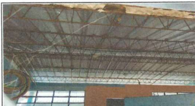
Foto 4: Deterioro de la estructura de techo bien oxidado, en los modulos 1 y 2.
